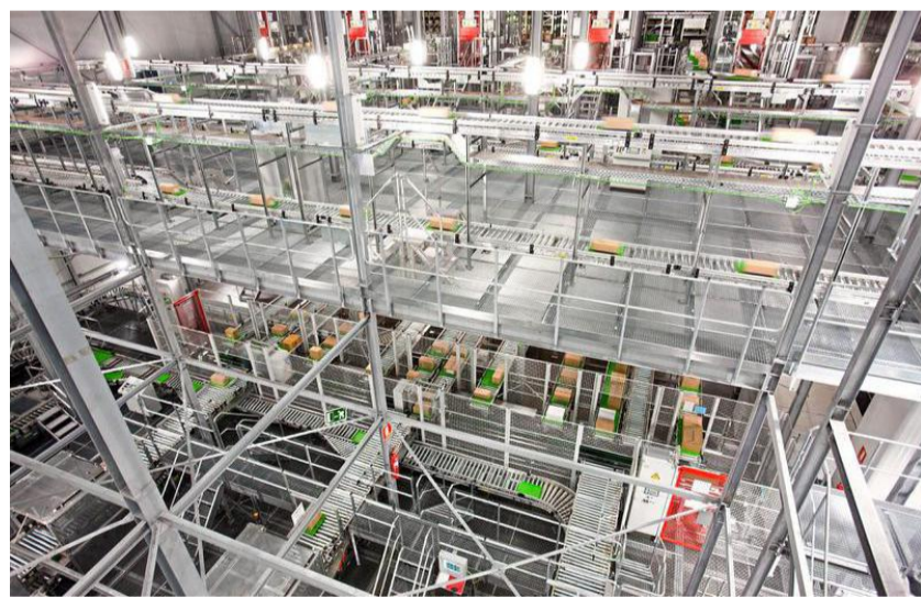
Planung entscheidet über Effizienz: Hightech von Witron in einem Lager von Mercadona.
